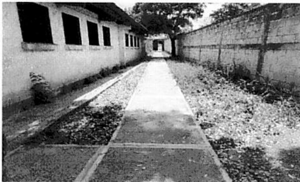
Losa de patio en la entrada principal
